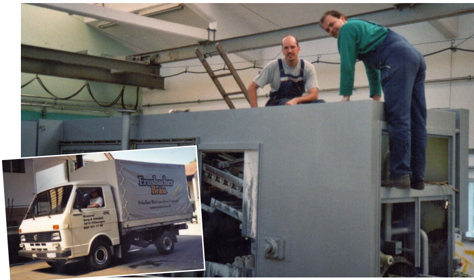
Die Firmengründer Hansruedi Schädeli (links) und Otto Sorg bei der Installation der Flaschen-Reinigungsanlage. Kleines Bild: «Der LT» – das legendäre erste Fahrzeug.
